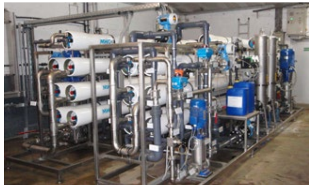
Die neue Membrananlage von Eing.
