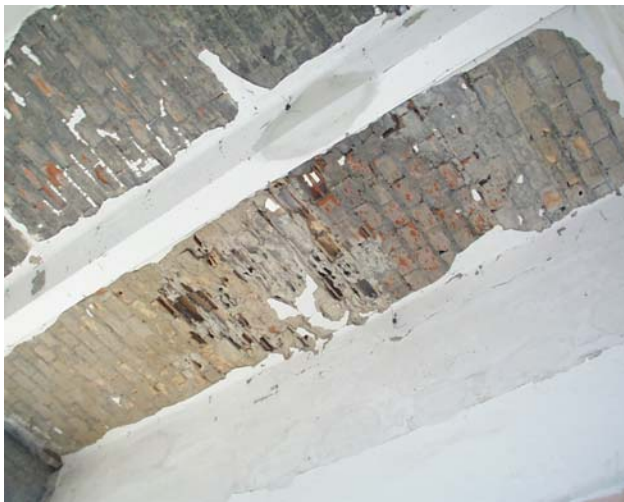
Foto: Sanierungsschäden einer historischen Hohlsteindecke aufgrund einer falschen Fraktionierungstechnik.
